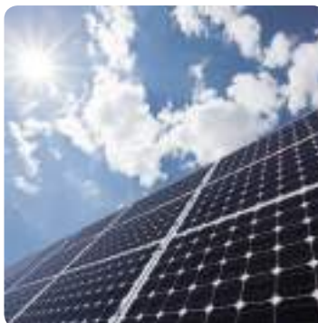
Energiegewinnung durch Photovoltaik bei EVVA
